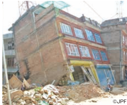
倒壊した家屋
